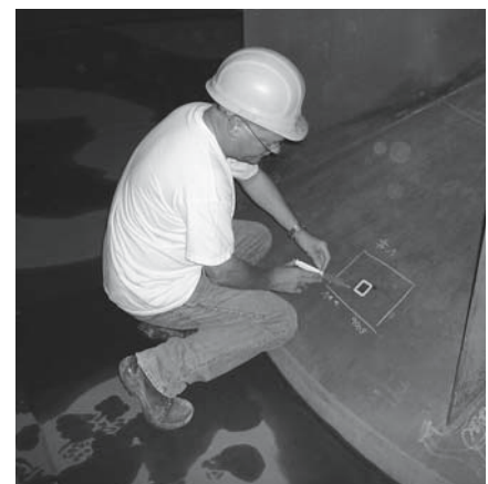
Salzmessungen, die nach der Oberflächenvorbereitung durchgeführt wurden, ergaben Werte von >70mg/m 2 Salzbelastung auf dem Substrat.
