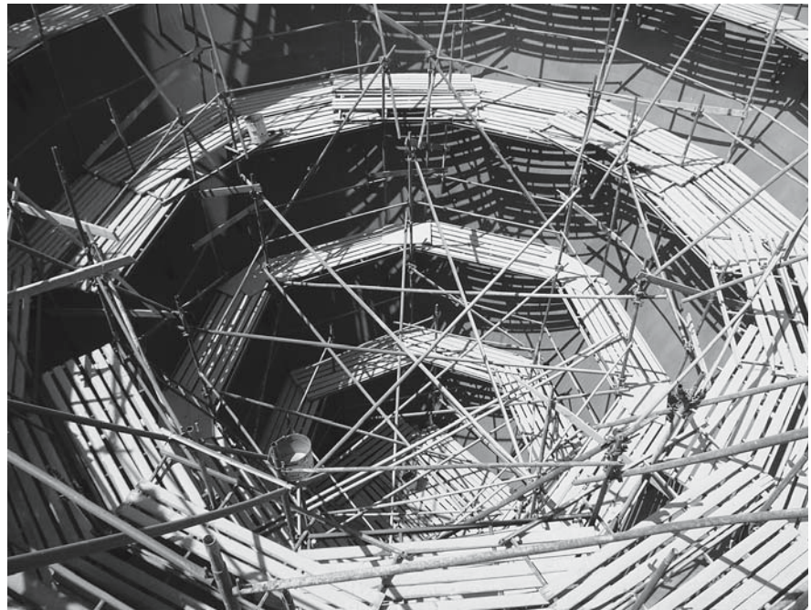
Die Innengerüste wurden nach „ortsüblichen“ Vorstellungen ausgeführt, ohne Rücksicht auf die Ausführungen im Leistungsverzeichnis.
